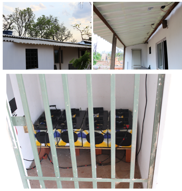
Figura 10. Infraestrutura de geração de energia solar e baterias de armazenamento
